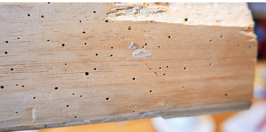
Hier hat der „Holzwurm“ – die Made des Nagekäfers – gearbeitet.
